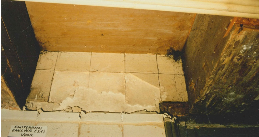
Afb. 17 Het voorste deel van de gang met oude tegelrestanten boven het moderne plafond, goed zichtbaar is hoe oude betegeling (boven) niet in lijn ligt met nieuw werk (onder).
