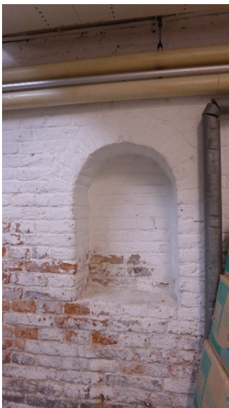
Afb. 29 Kaarsnis bij dubbele buitendeur met moderne latex verf
